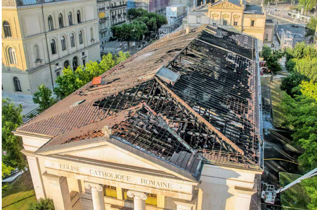
Vue de la toiture après l'incendie.
